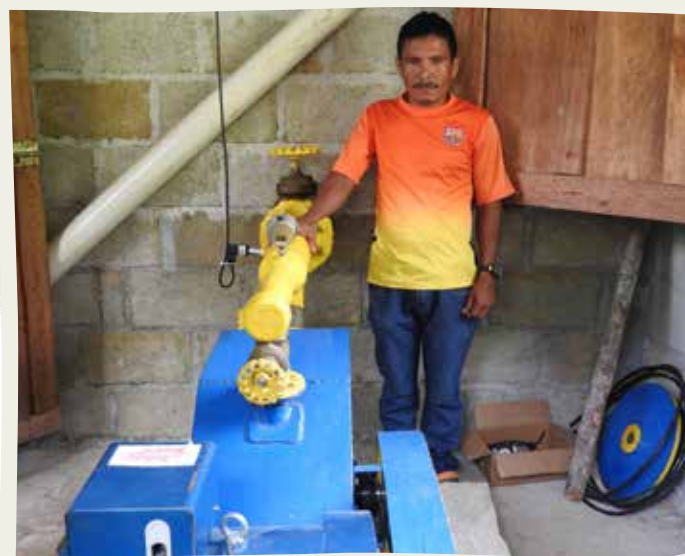
Sr. Reginaldo Romero Pineda, Presidente de la Junta de Energía Eléctrica, junto a la microhidroturbina instalada.
